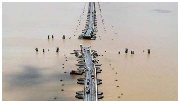
Les dommages du pont après l'incident. (Photo : Demerara Harbor Bridge Corporation)
