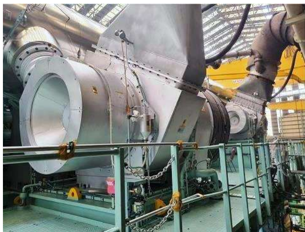
La turbosoufflante MET90MB installée sur le moteur d'essai.
