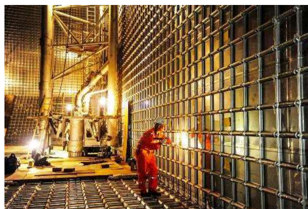
Intérieur d'une cuve de méthanier avec membrane en tôle gaufrée. Au fond, on aperçoit le système de pompage du méthane. (Photo : JMM)
